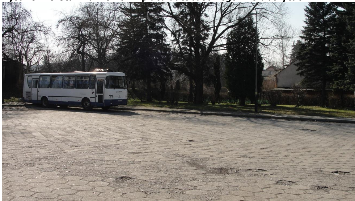
Rysunek 49 Stan nawierzchni placu autobusowego w Głubczycach
